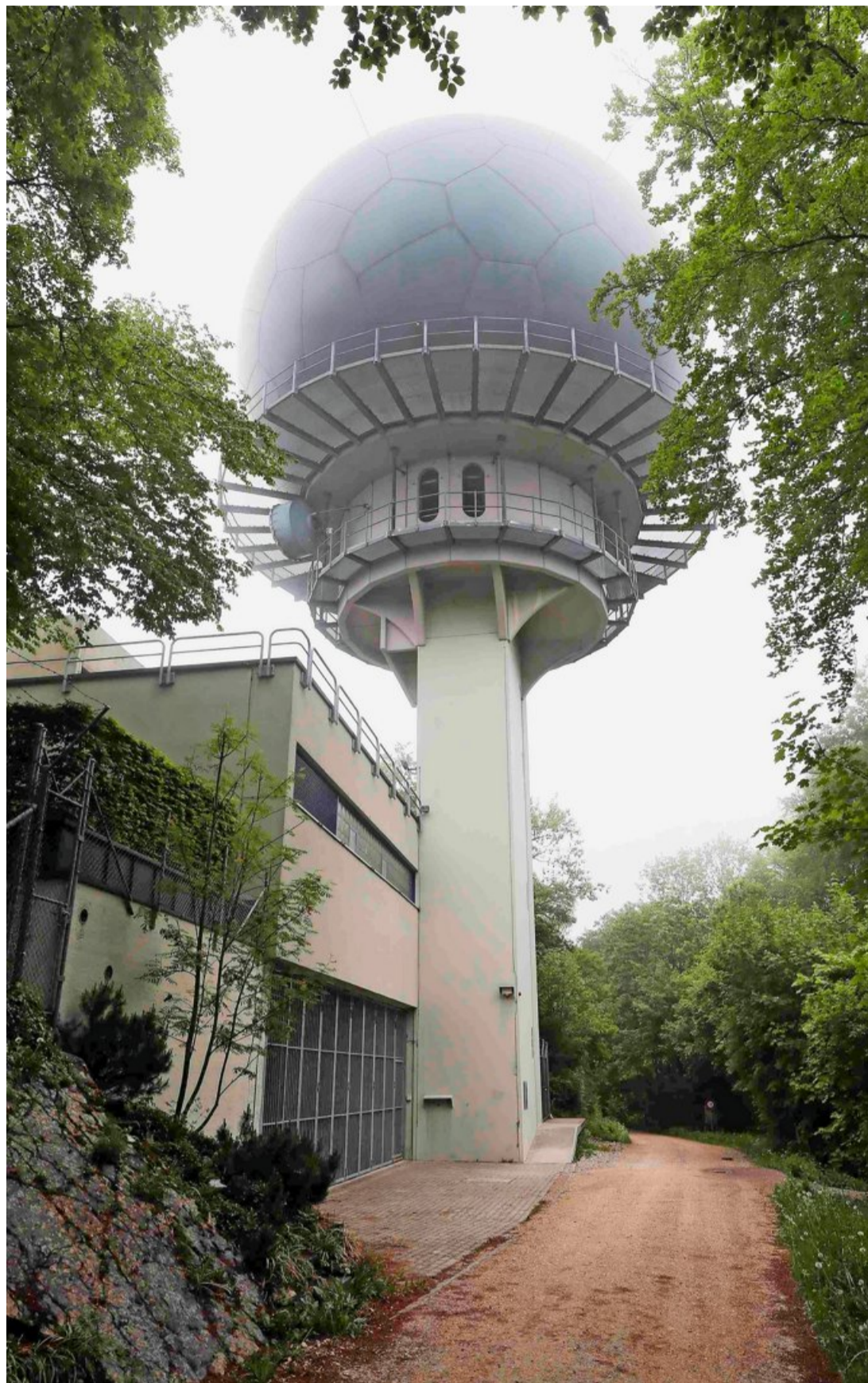
Da einige Teile der Wetterschutzhülle der Radaranlage auf dem Lägerngrat beschädigt sind, wird die ganze Kugel neu gebaut.
